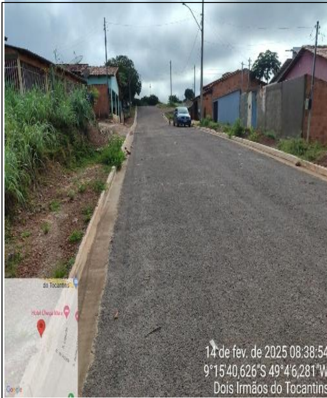
FOTO 03- Não existência do evento 3 calçadas
