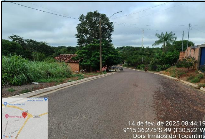
FOTO 03- Não existência do evento 3 calçadas
